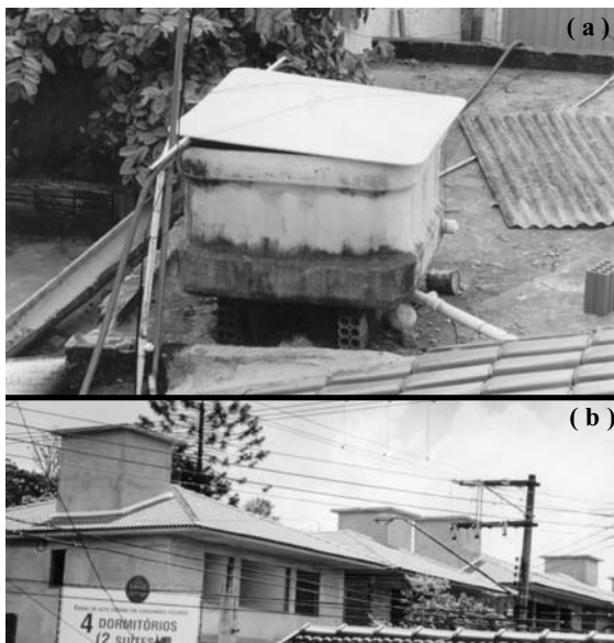
Figura – Reservatórios domiciliares: a) sobre laje de casa em Potim, SP; b) sobre telhado de conjunto residencial de luxo em São Paulo, SP.
